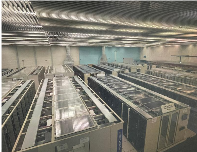
Figure 4 : Photographie des baies de stockage du centre de calcul du site de Meyrin du CERN 159
