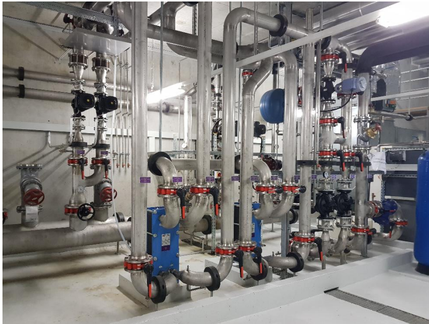
Figure 8 : Réseau de tuyauterie des pompes à chaleur de la centrale thermique de l'École polytechnique fédérale de Lausanne 240
